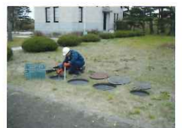
浄化槽保守点検・清掃
